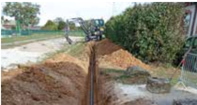
Conduite d'eau pour l'arrosage du terrain de football.
